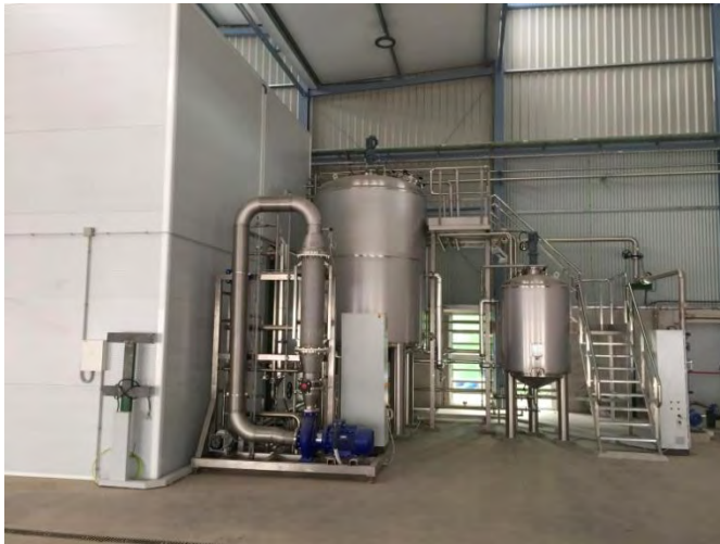
Área no ATEX con Sistema de microfiltración
