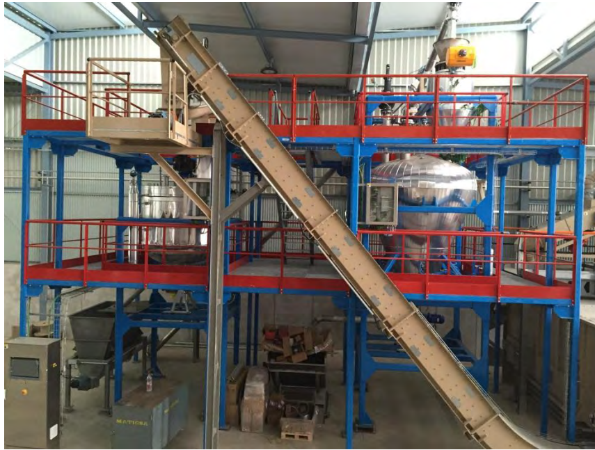
Reactores de Extracción y Explosión a Vapor
