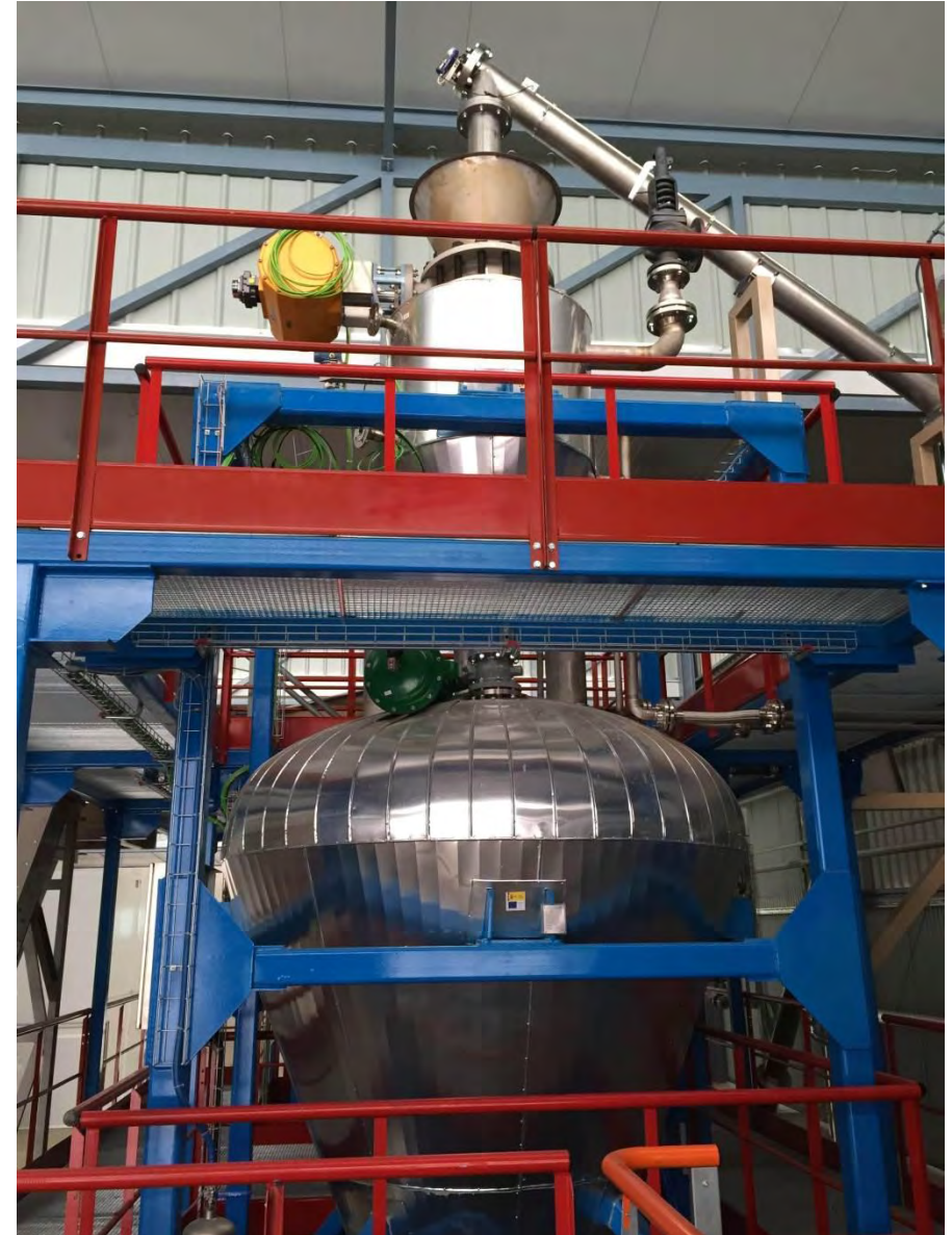
Detalle del reactor de Explosión a Vapor y Tanque de Expansión
